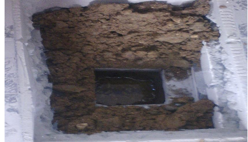
Wykop inspekcyjny – zaleganie wody opadowej pod posadzką
