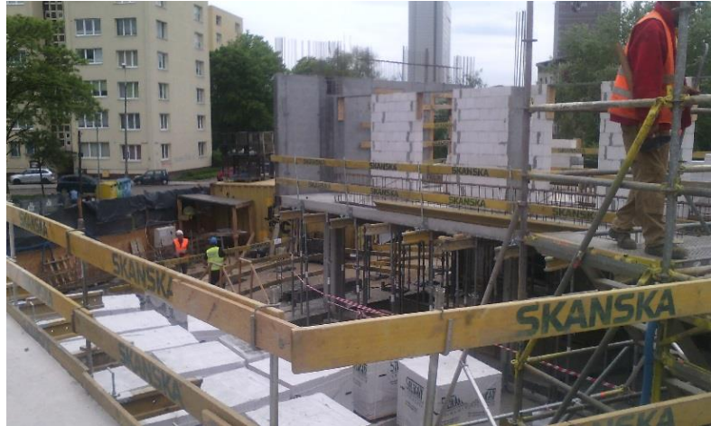
Brak zabezpieczenia posadzki budynku przed wodą opadową w trakcie budowy
