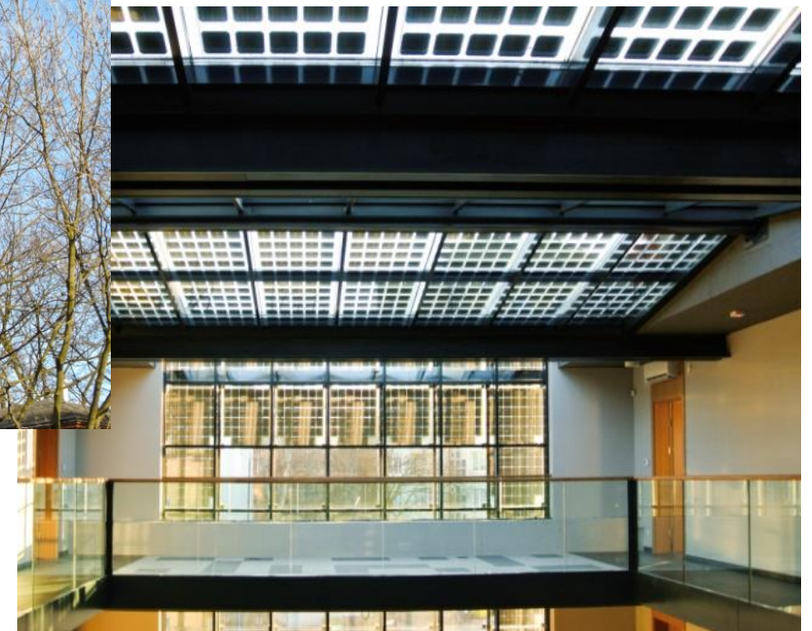
Część instalacja fotowoltaicznej w obrębie świetlika
