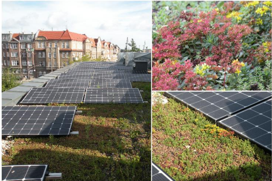
Panele fotowoltaiczne na dachu obiektu wraz z elementami koncepcji zielonych dachów
