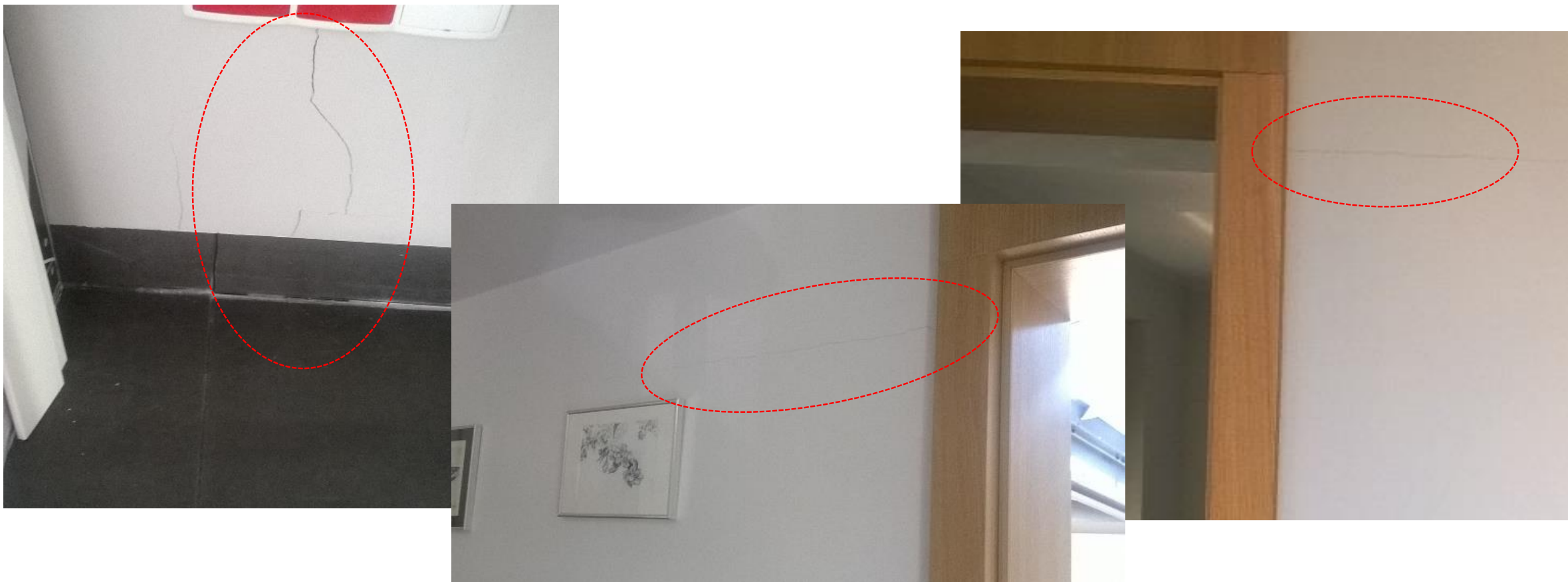
Pęknięcia ścian budynku
