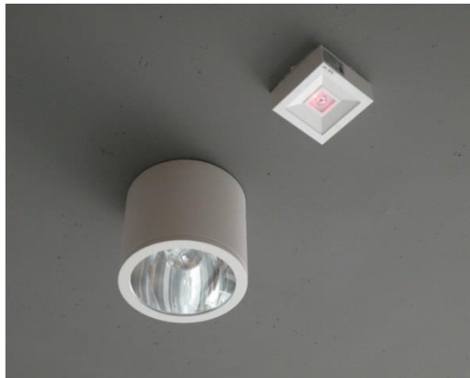
Energooszczędne oświetlenie typu LED w budynku
