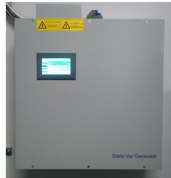
Falownikowy kompensator mocy biernej zainstalowany w WFOŚiGW w Gdańsku
