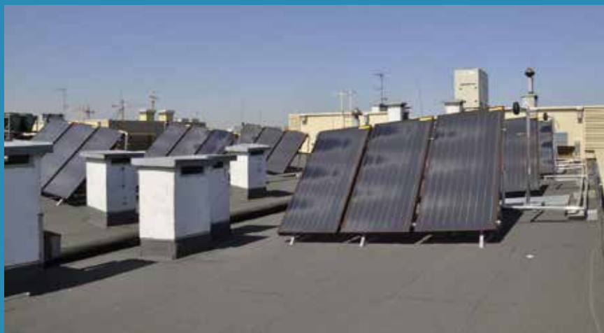
NFOŚiGW, kolektory słoneczne
