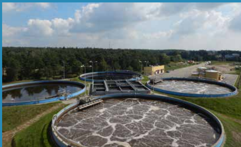
RCGW S.A. Tychy, reaktory biologiczne
